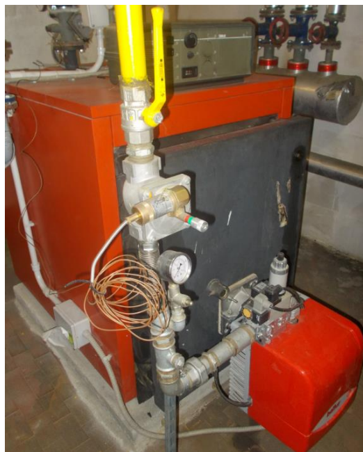
Figura 8.6 – Particolare della caldaia
