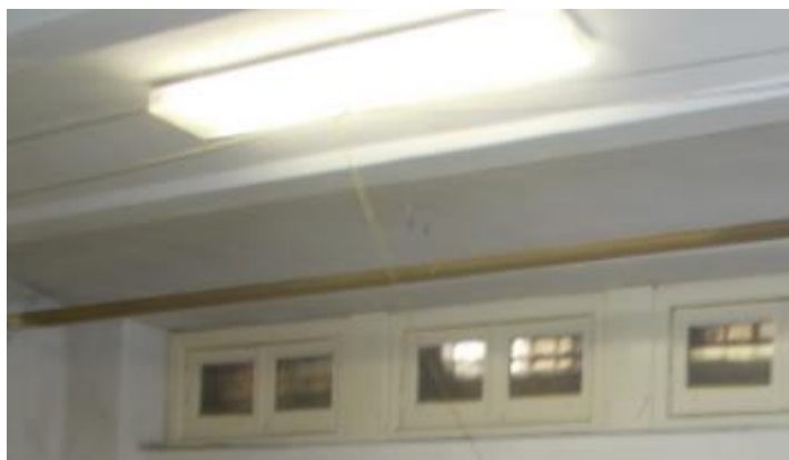
Figura 8.10 – Particolare di un corpo illuminante
