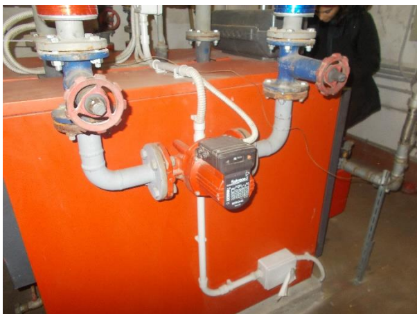
Figura 4.9 - Particolare del generatore
